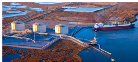
写真：建設中の天然ガス液化施設 (キャメロンLNGプロジェクト)
