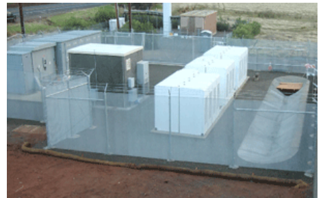
テスラ・パワーパックの技術を用いたPG&E初のリチウムイオン蓄電システム
